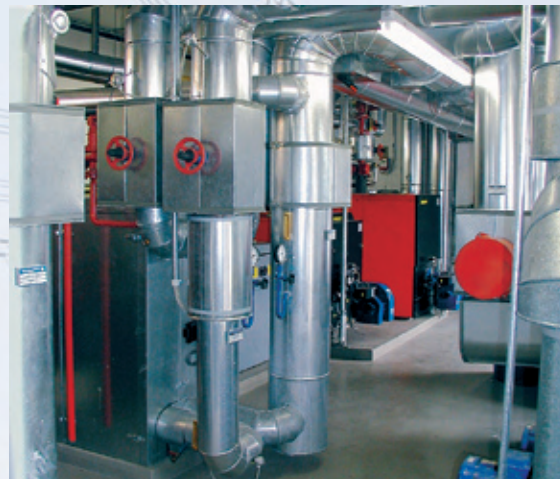
ПТО в системах отопления
