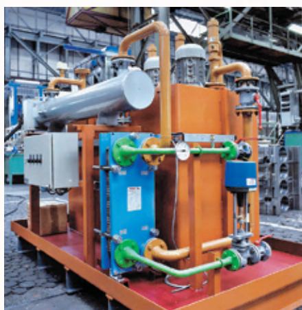
Охлаждение машинного масла в металлопрокатной промышленности
