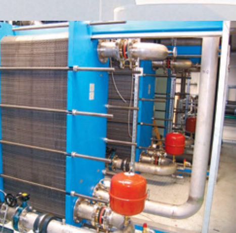
Центральный охладитель для стенда испытаний моторов
